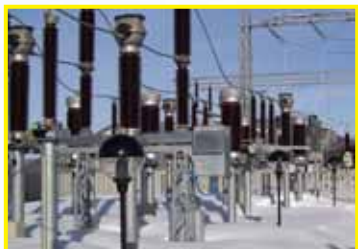
Sottostazione di Alta Tensione
